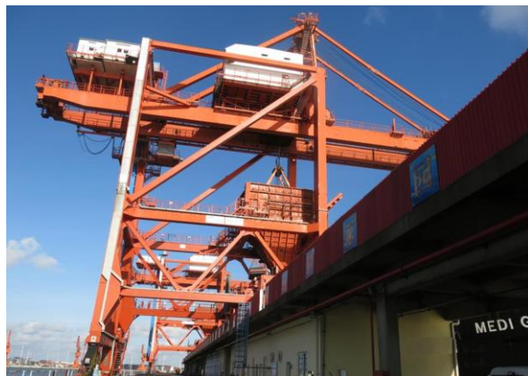
7万吨级码头前沿皮带机挡板
