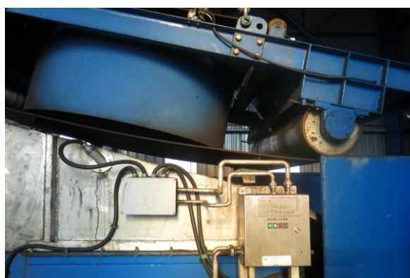
转运站干雾除尘系统
