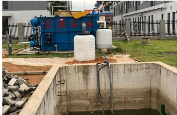
含油污水处理站
