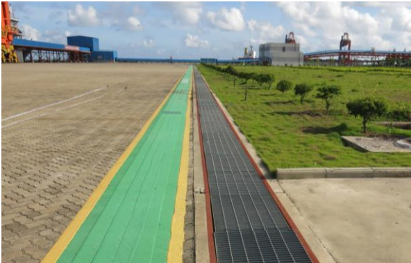
码头前沿作业区排水明沟
