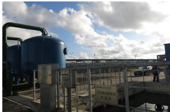
后方堆场含尘污水处理站
