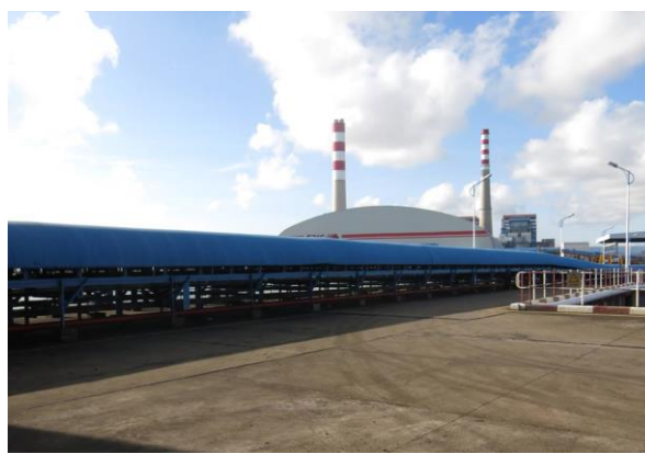
7万吨级泊位改建皮带机全封闭防尘罩
