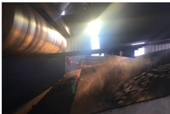
转运站干雾除尘系统
